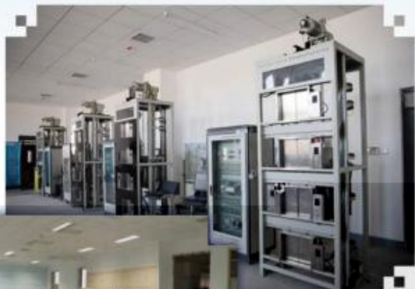
智能电梯安装调试 维护训练场所
